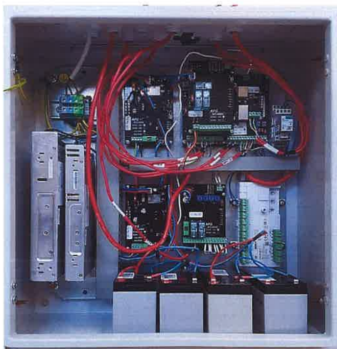
Fot. nr 2. Widok elementów wewnętrznych centrali typu AFG-4024/AFG-4048 Źródło: CNBOP-PIB.
