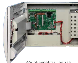
Widok wnętrza centrali
